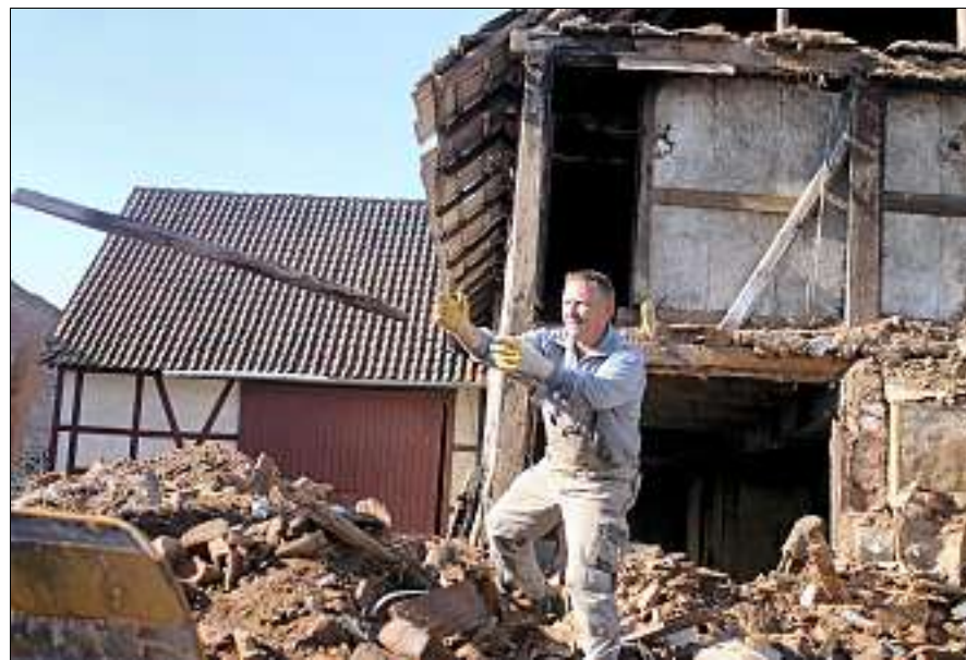
Der Wipperdorfer Andreas Fischer erstand den Hof bei einer Zwangsversteigerung. Nun wird das marode Wohnhaus abgerissen. Die Scheune bleibt stehen. Foto: S. Grimm
